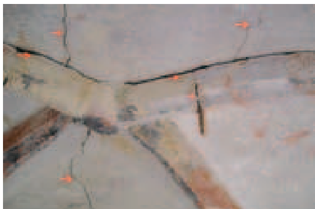
Plošný odkryv vrstev na křížové klenbě v presbytáři, vyznačení statických trhlin. / Large area removal of the surface layers on the rib-groined vault of the presbytery, marking the settlement cracks. Foto Václav Holoubek
