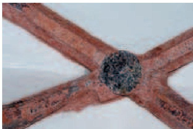
Klenební žebra – detail křížení. Stav po restaurování. / Vault rib crossing detail, after restoration. Foto Kamil Till
