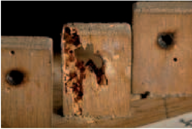
Panenka hřidelové desky hlavního stroje zcela zničená červotočem. / Rollerboard of the main division completely destroyed by woodworm. Foto Dalibor Michek
